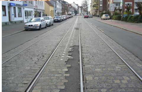
Instandhaltungs- und Wartungsfälle
