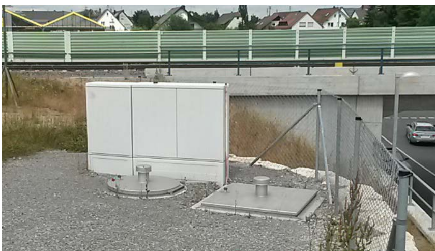
Bauwerkentwässerung: Hebeanlage mit anschl. RiStWag - Anlage
